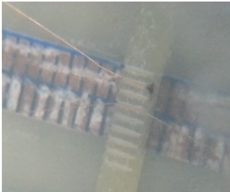
図 54 ワイヤーサポートでの沿面放電の様子 (放電前)
