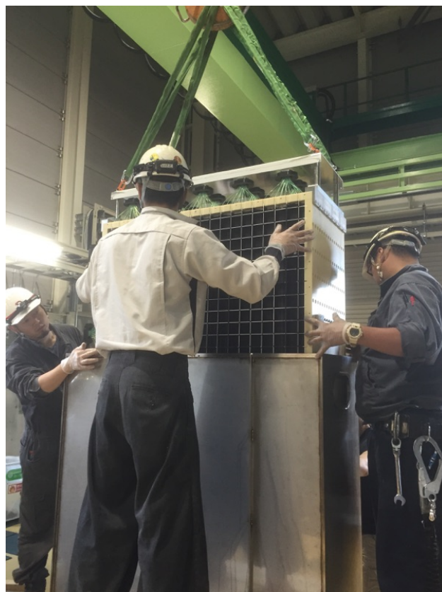
図 62: 組み合わせた sub-module を水タンクにインストールする様子
