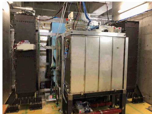
図 2.13 B2 フロア検出器群をビーム上流から見た写真
